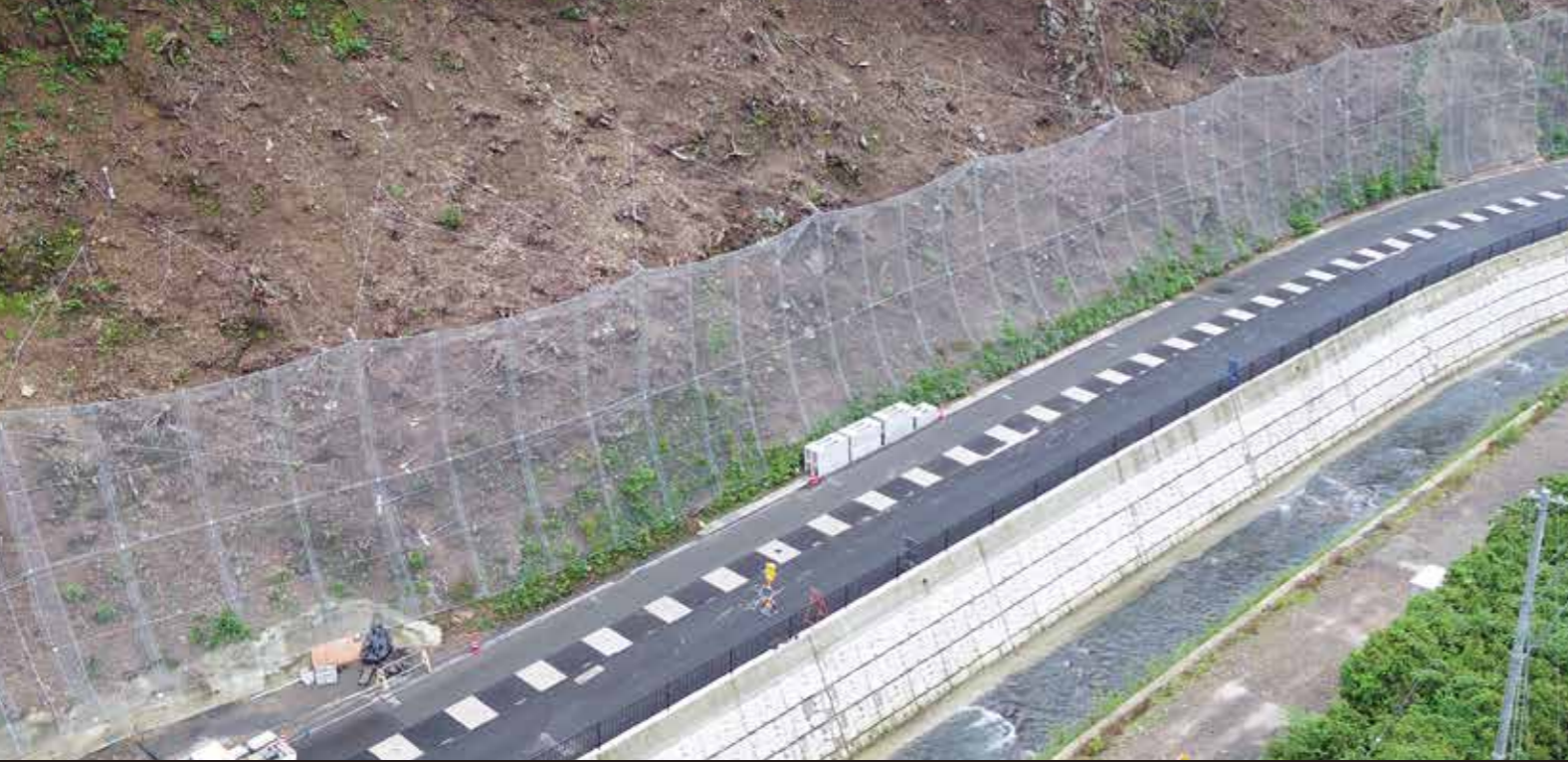
高エネルギー吸収型ポケット式落石防護網
