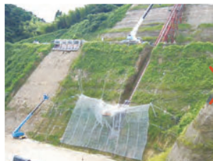
■ 重錘衝突状況 (BRN2100)
