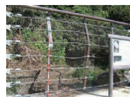
■ 落石の衝突事例
