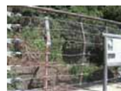
■ 落石の衝突事例
