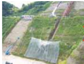
■ 重錘衝突状況 (BRN2100)
