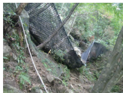
■被災状況(落石)
