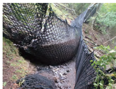
■被災状況(土砂)
