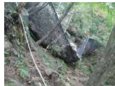
■被災状況(落石)
