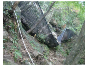
■ 被災状況 (落石)
