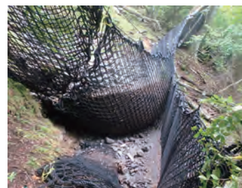
■ 被災状況 (土砂)
