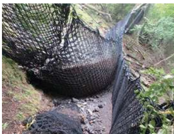
■ 被災状況（土砂）
