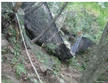
■ 被災状況（落石）
