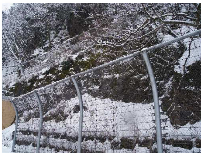
石川県 加賀市山中温泉大内町 (石川県 南加賀土木総合事務所)
