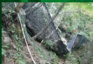
落石による被災状況（新潟県）
