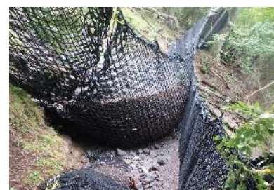
土砂による被災状況（栃木県）
