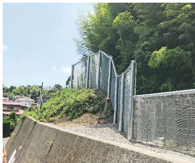
静岡県静岡市清水区草薙 支柱ジョイント HEF
