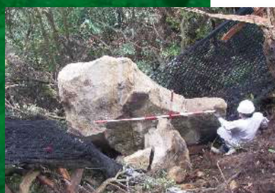
落石による被災状況（佐賀県）
