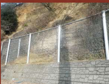
被災事例（崩土）
