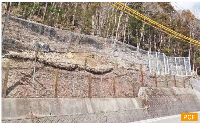
岐阜県下呂市金山町中切（中部地方整備局高山国道事務所）
