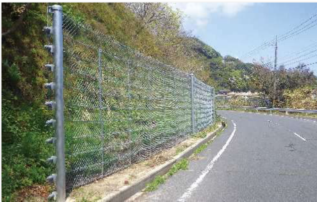
京都府宮津市島陰 (京都府丹後土木事務所)
