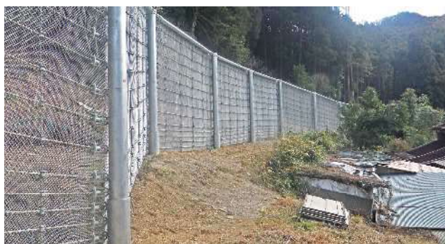
崩壊土砂・落石兼用柵、土石流・流木対策
