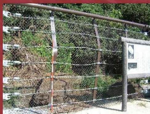
●落石の衝突事例
