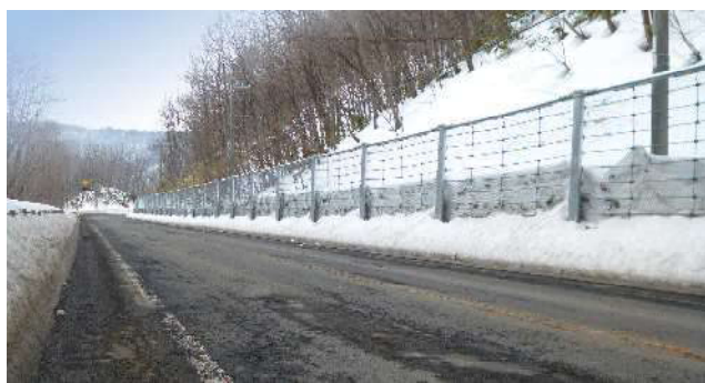
雪崩・落石兼用柵
