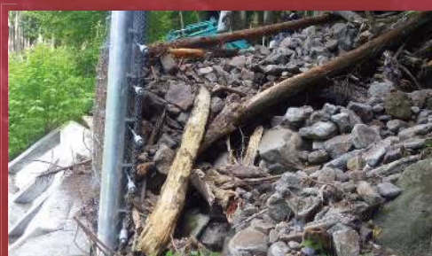
●崩土・流木の被災事例
